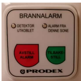
Bilde som viser panel ute i gangen for å avstille alarm inne i leiligheten.
